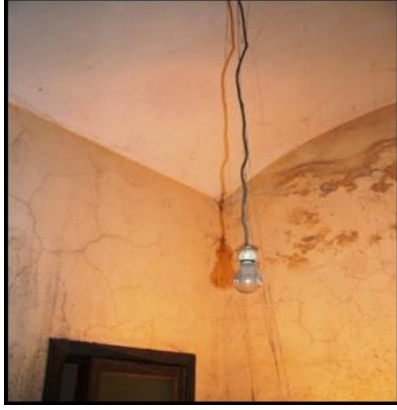
Resim 18: Kömürlük giriş arkası. Duvar ve tavan
